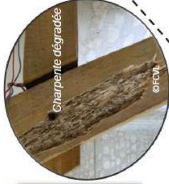
Plancher en ruine
