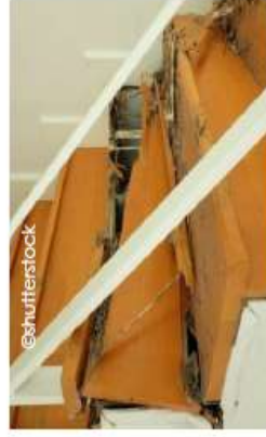
Escalier fortement fragilisé par des termites
